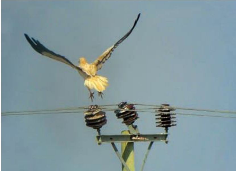
Der Ausbau des Elektrizitätsnetzes und die Errichtung schlecht konstruierter Strommasten bergen ein hohes Gefahrenpotenzial für Großvögel wie Geier.
